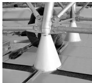
Fot. 7: Pokrycie dachu z wieloma przebieciami
