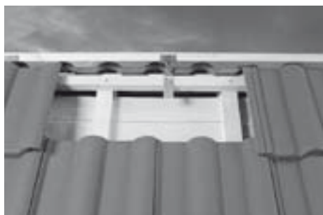
1. Przybić podpórki dwoma gwoździami na wcześniej włożoną tam na sztorc listwę kalenicową.
